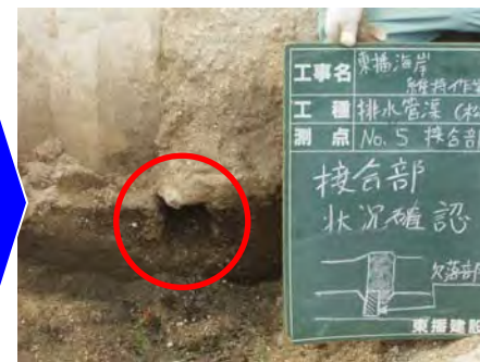
欠損箇所確認
