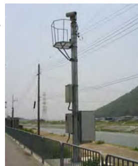
CCTVカメラ設置イメージ
