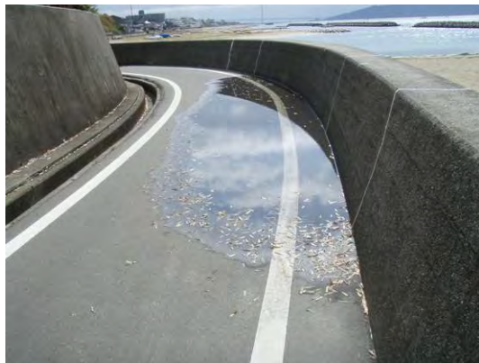
管理用道路排水不良 明石市谷八木付近 平成22年3月撮影
