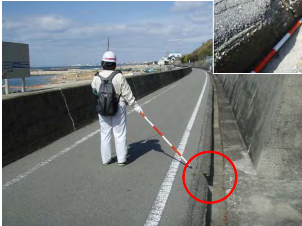
側溝壁の損傷 明石市藤江付近 平成22年3月撮影
