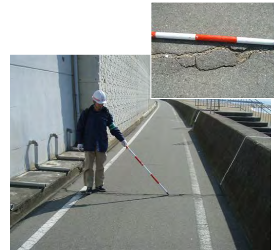
管理用道路損傷 明石市藤江付近 平成22年2月撮影
