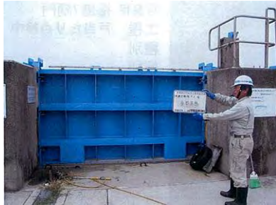
門扉動作確認
