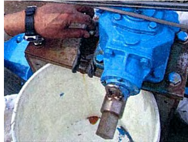
開閉装置潤滑油交換
