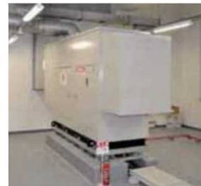
非常用発電設備のイメージ
