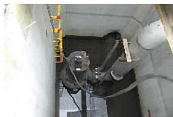
⑭生石研修センター前雨水ポンプ
