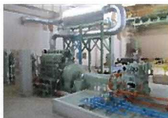
④荒井ポンプ場(増設)
