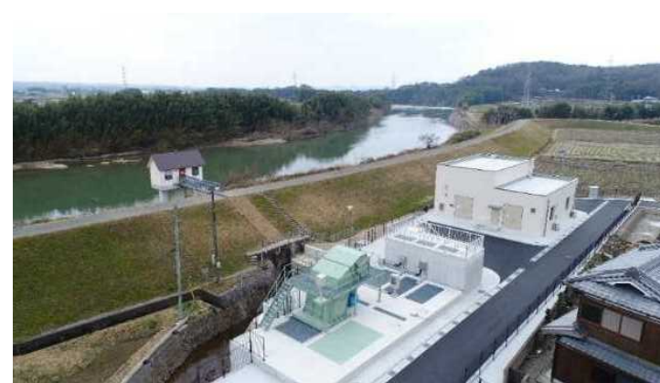
河高地区安取雨水ポンプ場全景
