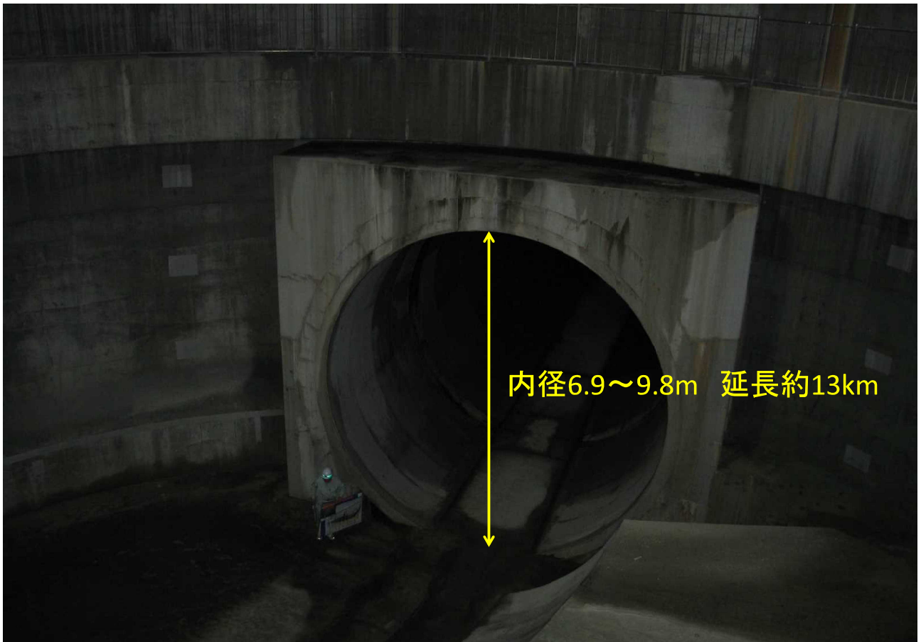
寝屋川南部地下河川(寝屋川流域)
