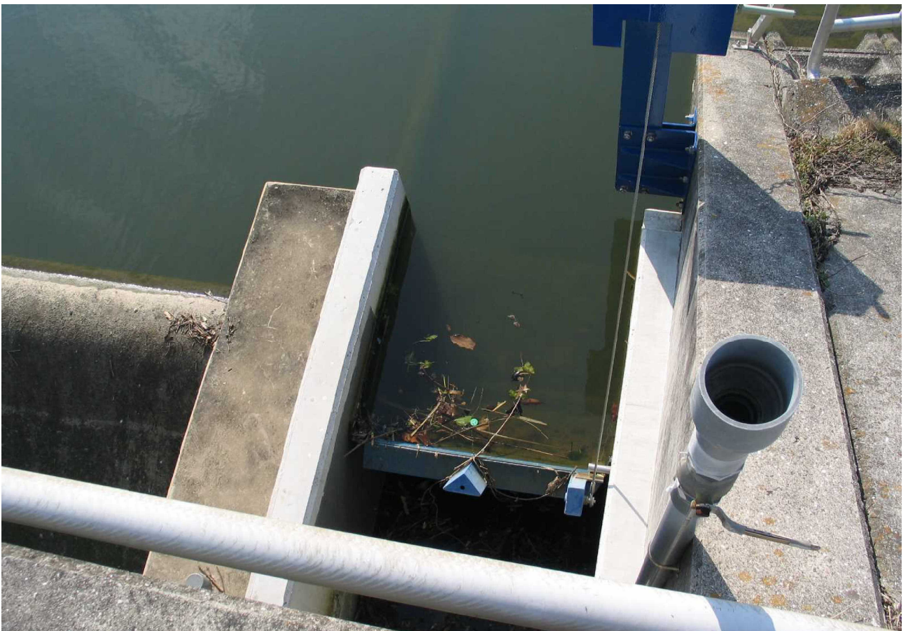
寄合池の洪水吐に設置された切欠き
