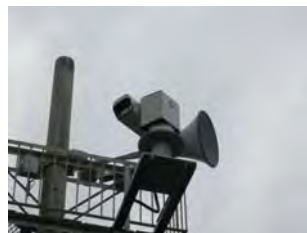
河川監視カメラ（CCTV）
