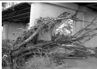
安全な流下に支障となる樹木（加古川橋）
