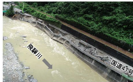
国道41号 道路崩壊 (岐阜県下呂市)
