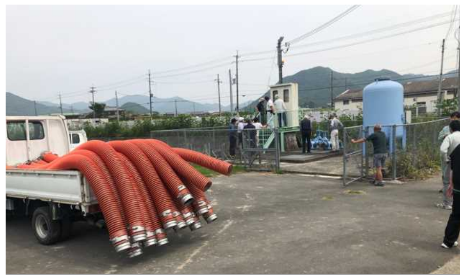
農業用用水ポンプ 河川排水準備
