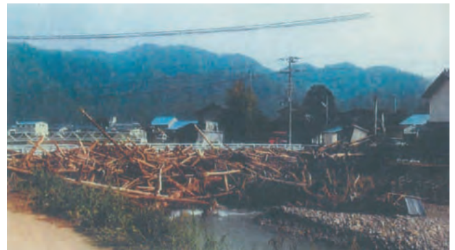
流木等が橋梁に引っかかっている実例 (兵庫県出石町/台風23号)
