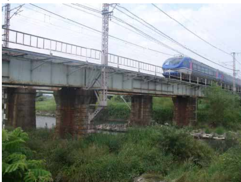
図-2.4.1 既存不適格の橋梁：JR山陽本線鉄道橋
