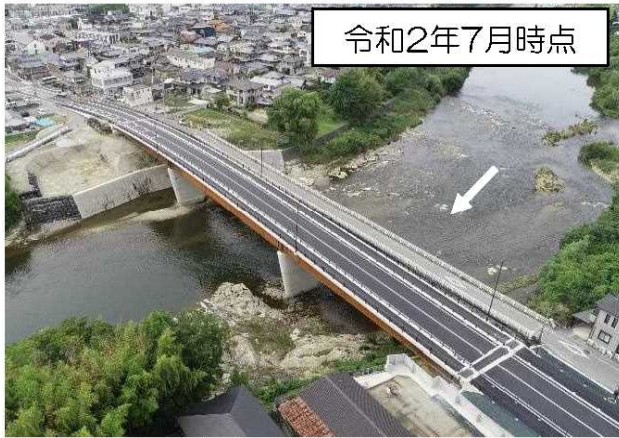
令和2年7月時点 加古川橋梁改築工事 (加東市・国直轄管理区間)
