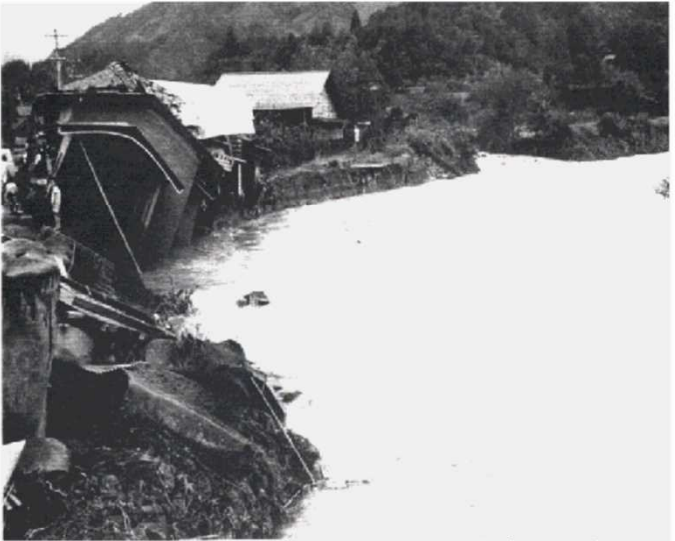
増水による護岸の流出
