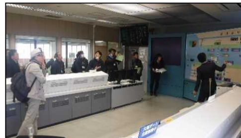
毛馬排水機場
