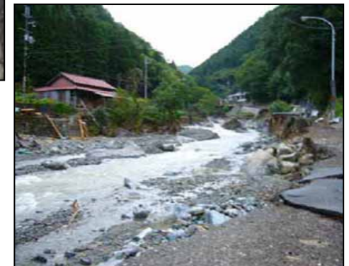
樽垣内橋の流出
