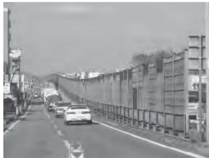
古くなった遮音壁
