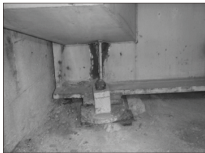
老朽化の状況（鋼材の腐食）
