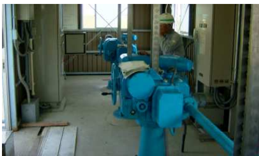
樋門施設の保守
