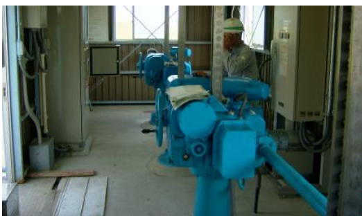
樋門施設の保守
