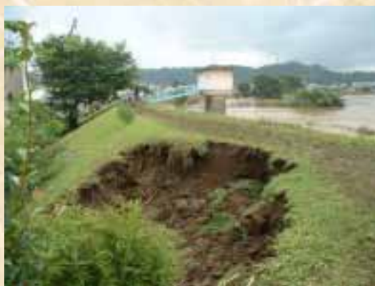
越水による堤防のり面浸食 (福島市春日)
