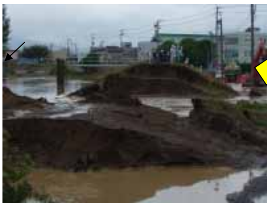
破堤時(足羽川・福井市春日一丁目)
