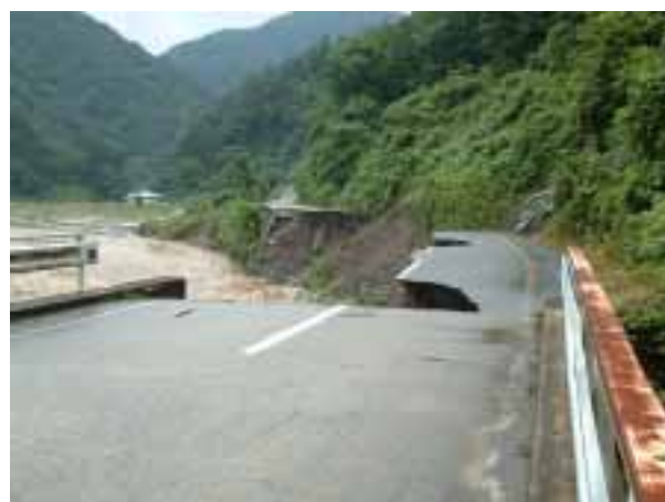
一般国道157号(大野市中島) 道路流失
