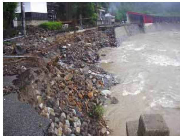
一般国道476号(美山町折立) 道路流失
