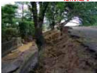
堤防裏法洗掘
