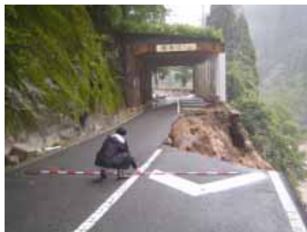
一般国道476号(寺田町持越) 道路損壊
