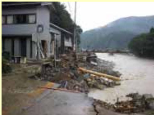
一般国道476号(美山町西河原)道路流失
