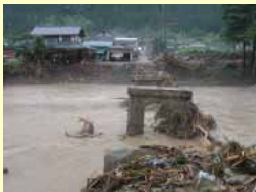
町道東河原線(美山町西河原地係)落橋
