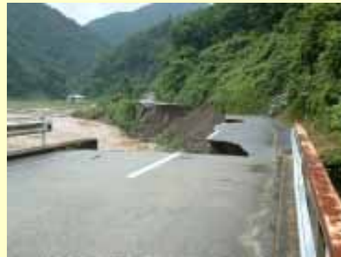
一般国道157号(大野市中島)道路流失
