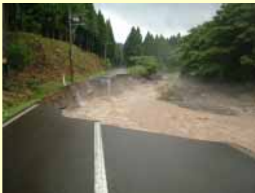
(主) 松ヶ谷宝慶寺大野線 (大野市木本) 道路流失
