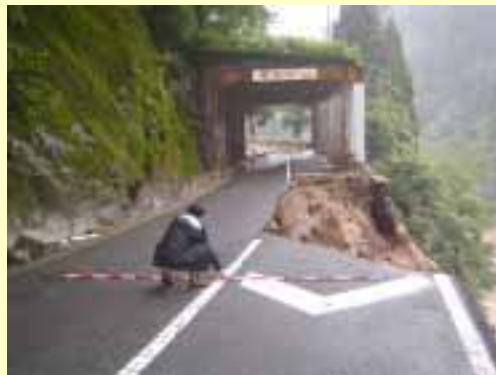
一般国道476号(池田町持越)道路損壊
