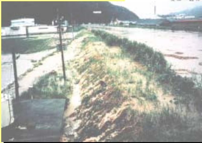
堤防からあふれ出す (浅水川右岸)
