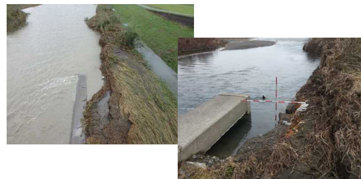
護岸背面の土砂が流出している様子 【一次評価】点検者等が機能低下の状態・進行性を評価
