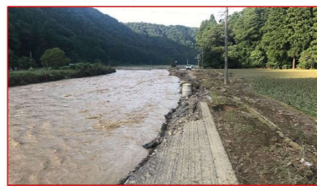
鹿蒜川流域(南越前町南今庄付近) 令和4年8月5日 出水
