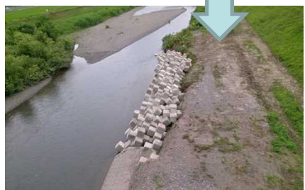
土砂で埋め戻した後、 根固ブロックで浸食 防止措置を行った。
