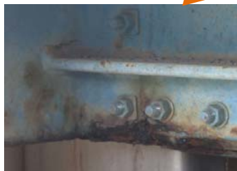
水密ゴムの劣化
