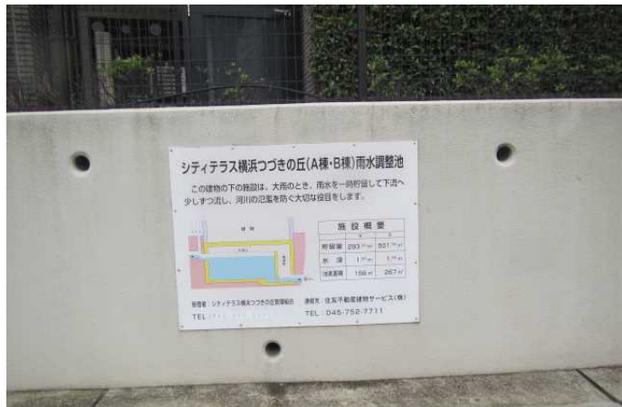
地下貯留施設を示す看板の例
