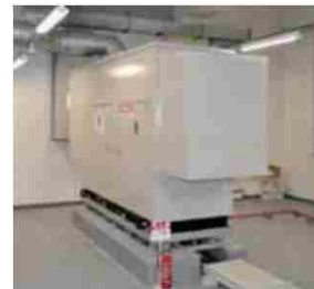
非常用発電設備のイメージ
