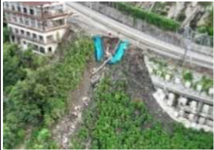
国道8号被災状況
