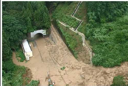
北陸自動車道被災状況
