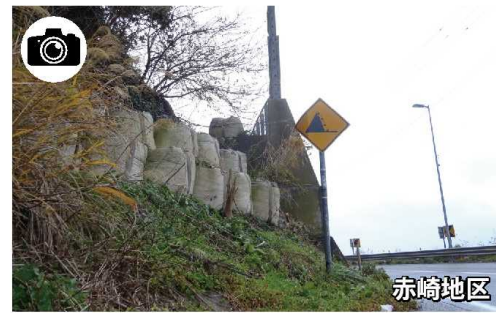
防災点検要対策箇所の状況
