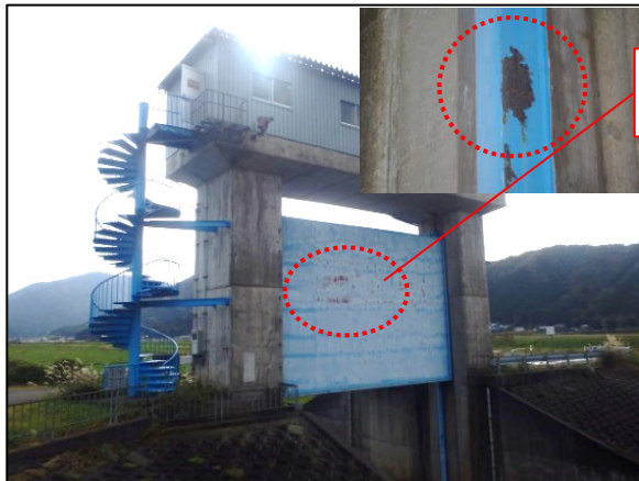
中川水門（北川右岸6.2k付近） 扉体塗装塗替等を実施（平成30年度）
