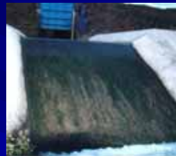
北川との落差 230cm (瓜生第1排水樋門)
