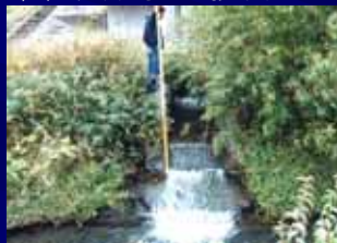
北川との落差 65cm (大鷲樋門)
