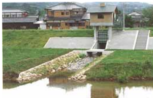
落差を解消した樋門
