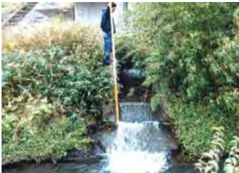
北川との落差 65cm (大鷲樋門)
