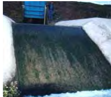
北川との落差 230cm (瓜生第 1 排水樋門)
