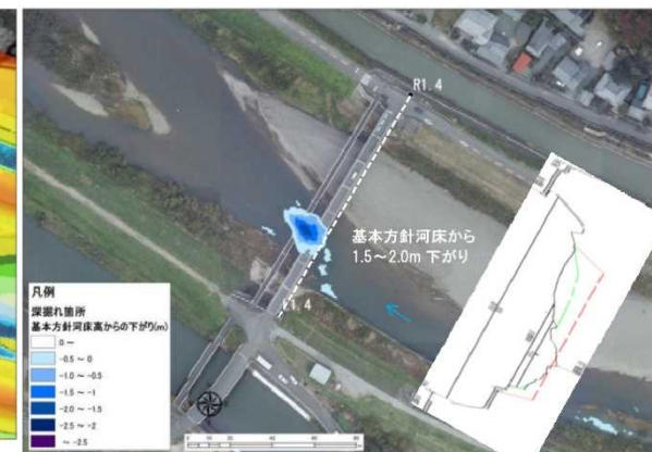
図 6.32 丸山橋 橋脚基礎部の洗濯状況
