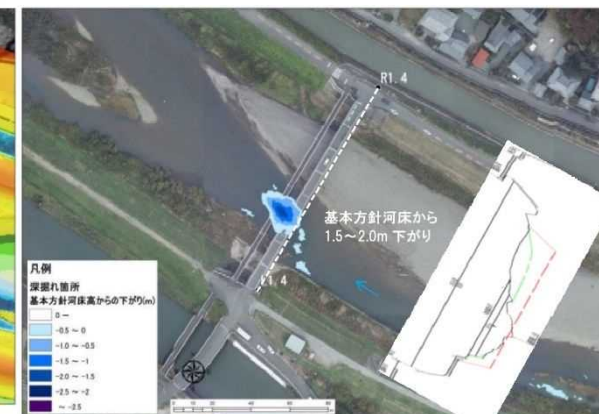
図 6.32 丸山橋 橋脚基礎部の洗掘状況
