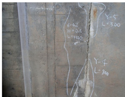
管渠内クラック状況
