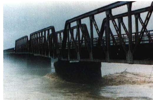
昭和 56 年 7 月洪水（梅雨前線） 高屋橋（県道福井三国線）の橋脚が洗掘のため傾いた
