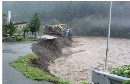
河岸侵食状況 (池田町持越)
