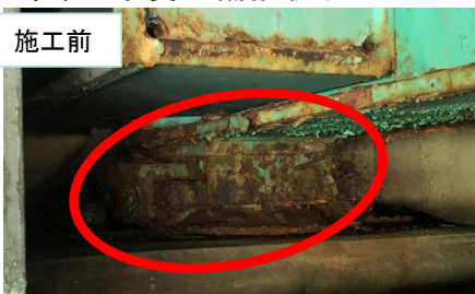
施工前 支承の腐食
