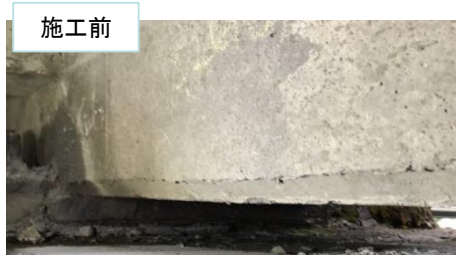
施工前 支承の腐食
