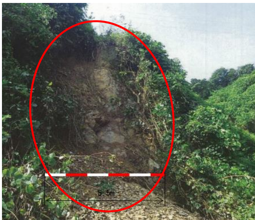
落石崩壊状況
