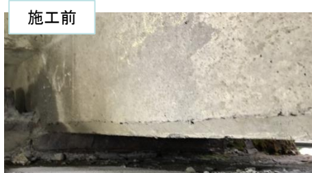
施工前 支承の腐食
