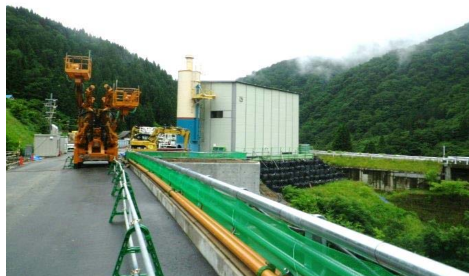
トンネル工事に必要なプラント設備
