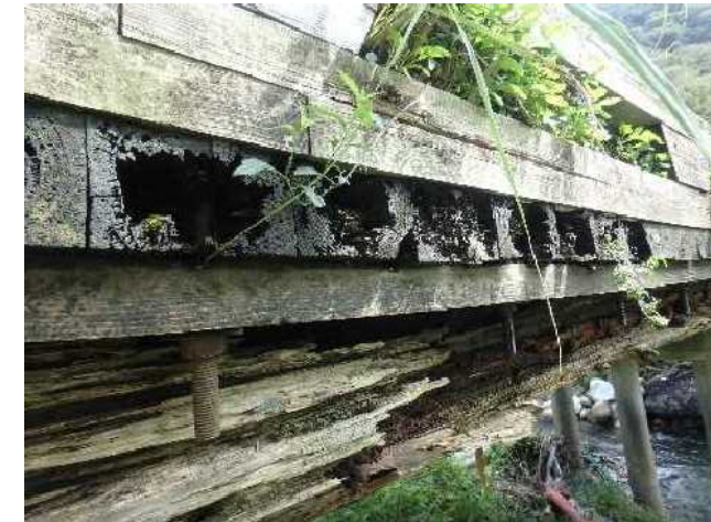
床版の腐朽(木製)
