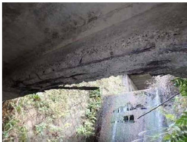
鉄筋破断を伴う剥離・鉄筋露出
