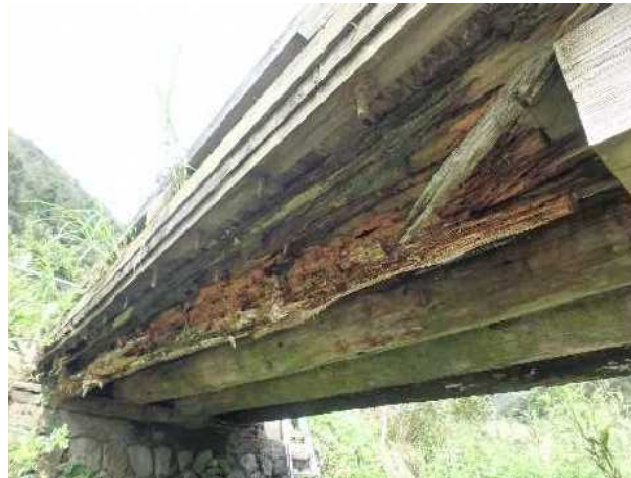
主桁の腐朽(木製)
