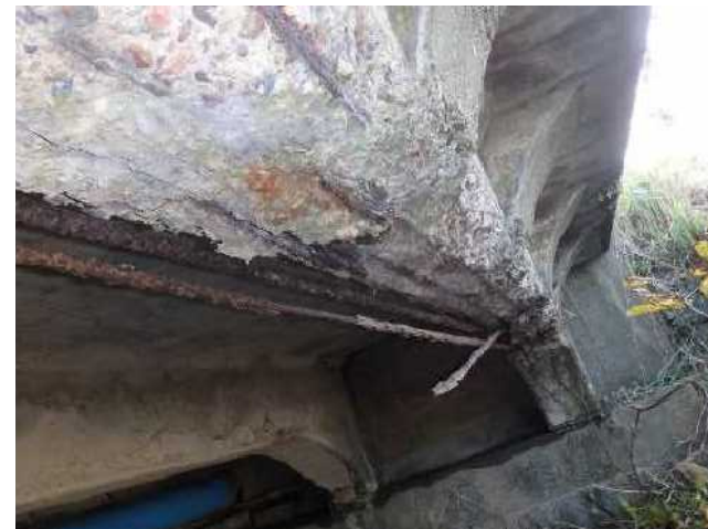
鉄筋破断を伴う剥離・鉄筋露出
