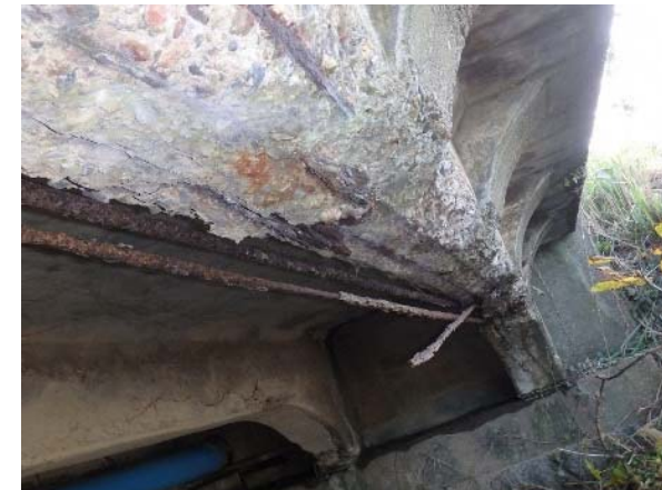
鉄筋破断を伴う剥離・鉄筋露出
