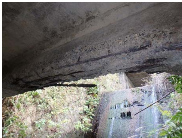
鉄筋破断を伴う剥離・鉄筋露出
