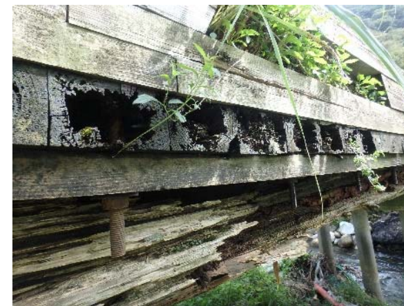
床版の腐朽(木製)
