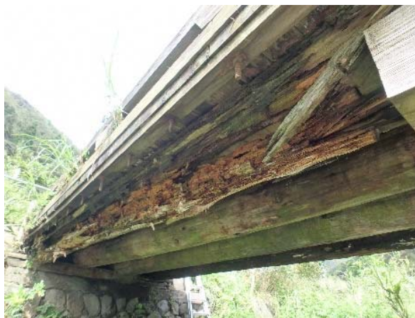
主桁の腐朽(木製)
