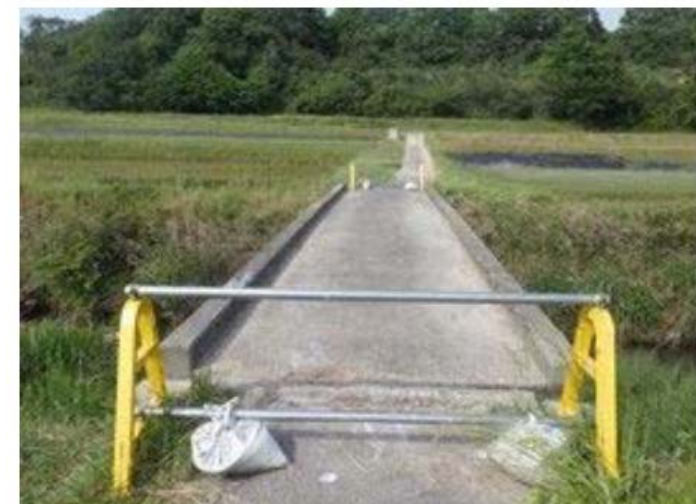
通行止め状況
