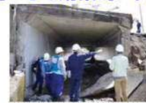
熊本地震における地方公共団体管理施設の被害状況調査
