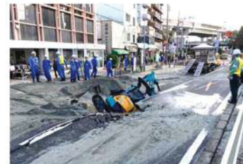
埋設管の老朽化に伴う道路陥没
