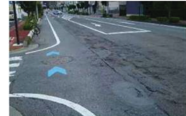
占用工事が起因する路面損傷
