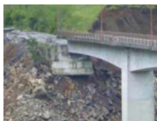
斜面変状による橋台の沈下
