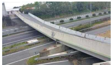
ロッキング橋脚を有する橋の落橋
