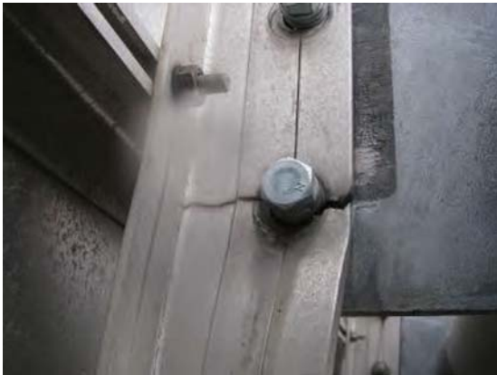
き裂損傷 (車両衝突)
