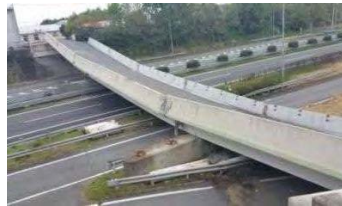
ロッキング橋脚を有する橋の落橋
