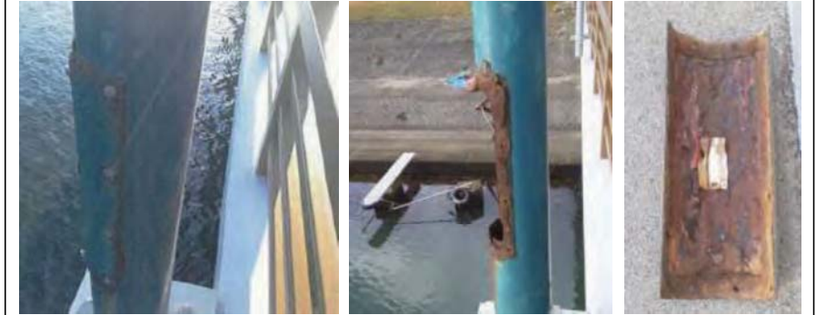
転倒した照明柱と同タイプの状況
