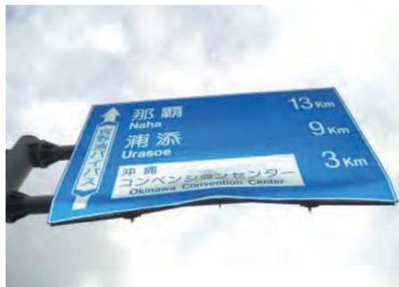
異常変形 (車両衝突)
