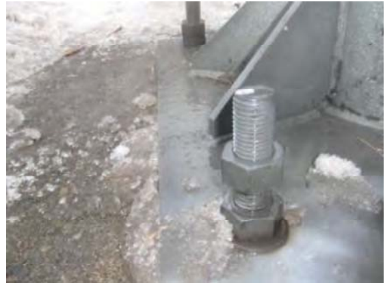
ボルトの緩み (施工不良)
