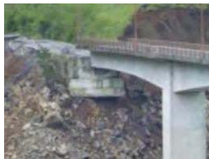
斜面変状による橋台の沈下
