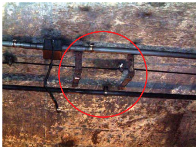
落下後の照明取付け部
