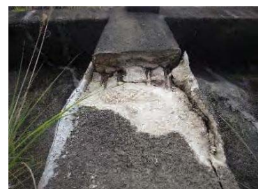
法枠工の老朽化損傷
