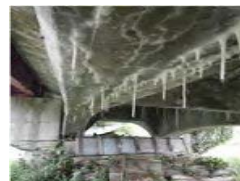
主桁のひびわれ
