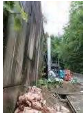
写真 壁面の傾斜の例
