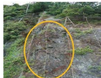
写真 落石防護網の著しい腐食による断面欠損の例
