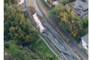
国道443号 ましまち 益城町
