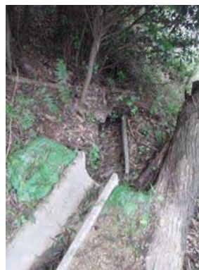
写真 排水溝の破損の例
