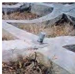
写真 受圧構造物の破損の例
