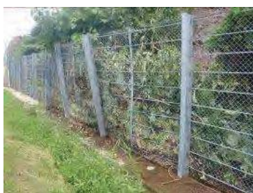
写真 落石防護柵の傾動の例
