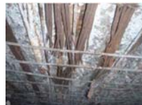
PC鋼材の腐食例
