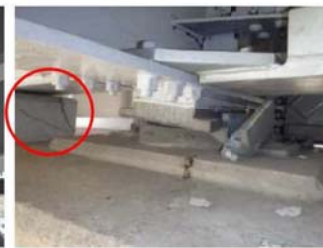
写真-6 支承の破損の状況
