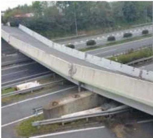
九州自動車道をまたぐロッキング橋脚の落橋 (県道小川嘉島線・府領第一橋)
