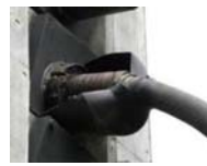
ケーブル損傷例
