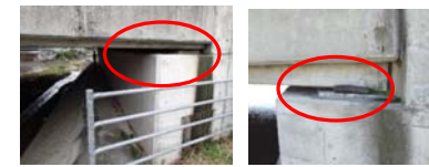
支承交換の作業空間なし
