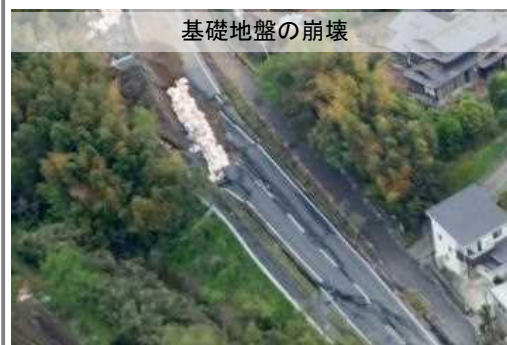
写真-9 国道443号 (益城町)
