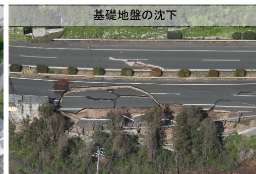
写真-10 九州自動車道 (益城町)
